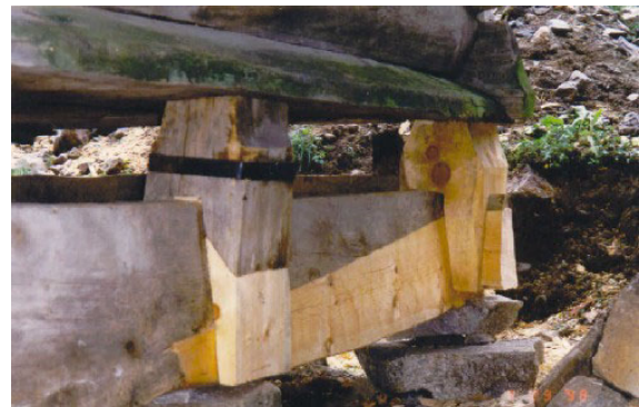
Bilete 2.23: Sikring av skada trestabbe for ombruk vha. jernklave på Muggslopte, Innestog Byklum, Bykle. Sjå ein ny og utskifta stabbe i bakgrunnen.
