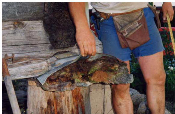
Bilete 2.28: Dekke over råteskade med sink/bly, stolpehus, Helle, Hylestad.
