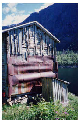
Bilete 2.32: Dekke over råteskade med sink/bly, løene, Brotteli, Bykle og Helle, Hylestad.
