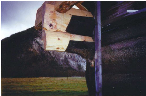
Bilete 2.9: Råteskada skakestokk er spunsa etter antikvariske prinsipp på lopt, Dale, Valle.
