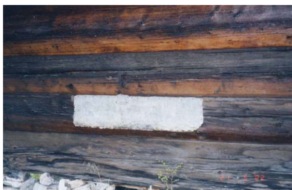
Bilete 2.29: Dekke over råteskade med sink/bly, bu, Henriksentunet, Bykle.
